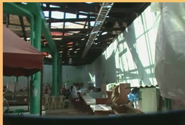
Los destrozos del vendaval de agosto 2011 en pabellón 1. Foto 26: Bernardo Sánchez
